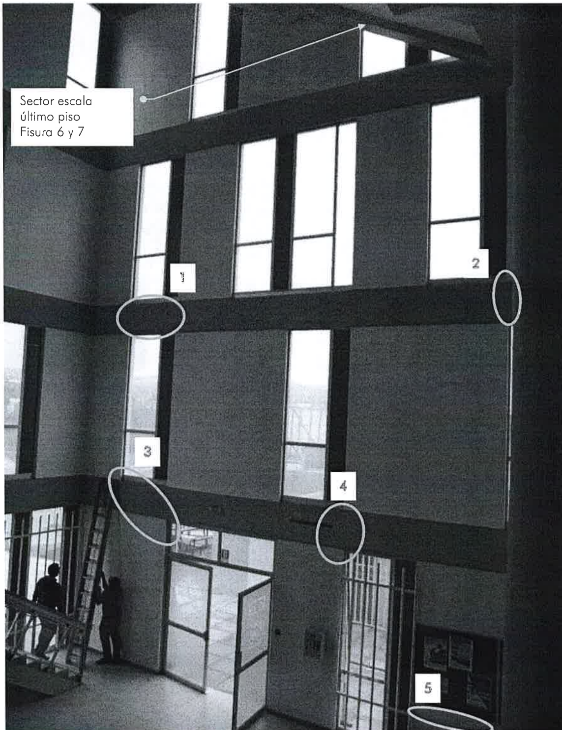
Vista interior de las fisuras en la fachada 2
